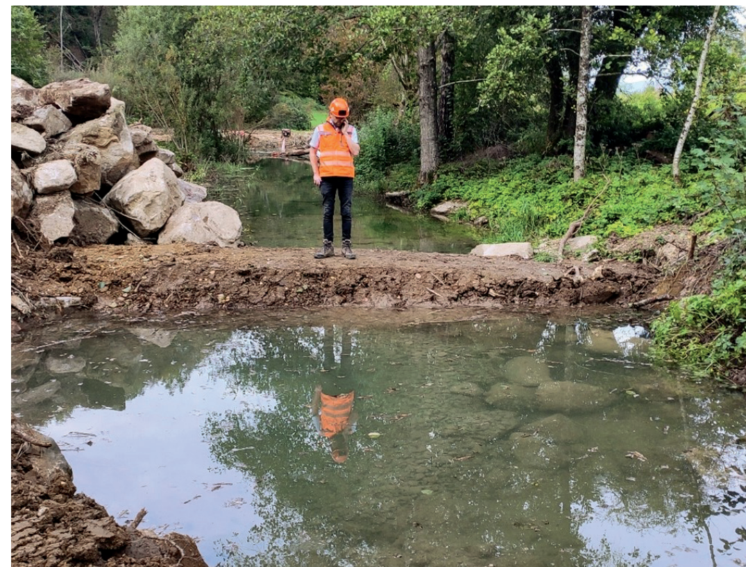
▼ Vorne die mit den Bauarbeiten aufgedeckte Fliessquelle, hinten der aufgedeckte Giessen im «Rohzustand». Ein Giessen wird aus Quellwasser und – in unverbauten Gewässern – in im Boden nachfliessendem Bachwasser gespiesen.
